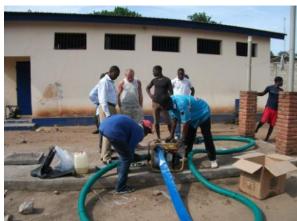
Die Kanalisation ist verstopft!!
